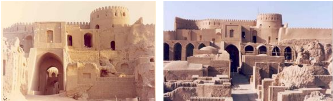
شکل ۴: دو نما از جبهه‌ی درونی دروازه‌ی اصلی در پیش از زلزله‌ی سال ۸۲ خورشیدی، الف. نمایی عمومی دو جبهه‌ی غربی و شرقی و رواق‌های بازسازی‌شده، ب. نمای جبهه‌ی غربی، پیش از مرمت رواق‌ها (مأخذ: بایگانی پایگاه میراث جهانی ب‌م و منظر فرهنگی آن).
