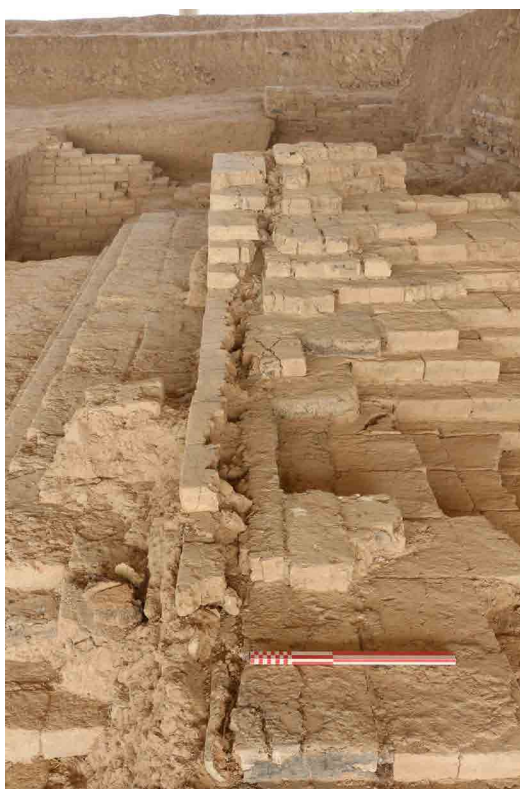
شکل ۴۰: شکاف طولی ایجاد شده در اثر زلزله در دیوار شرقی دروازه، گمانه ۲۳ (هیأت مشترک ایران-ایتالیا).
